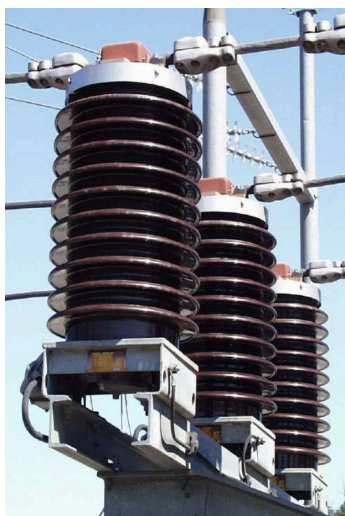
Fig. 13 Juego trifásico de transformadores de intensidad
