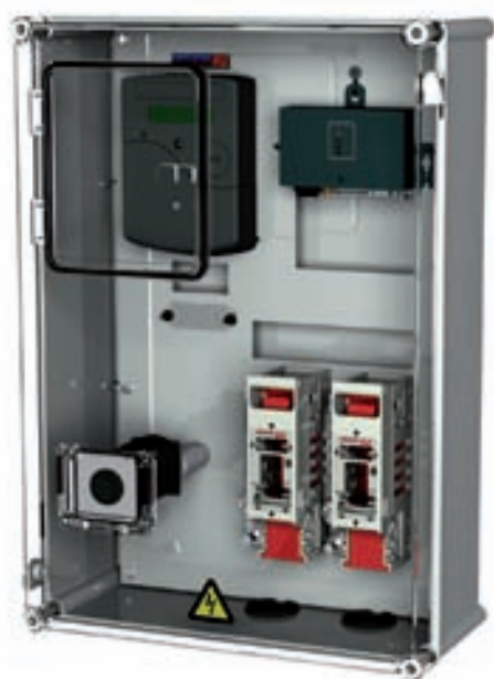
CA-1ME-FOT (instalación interior)
