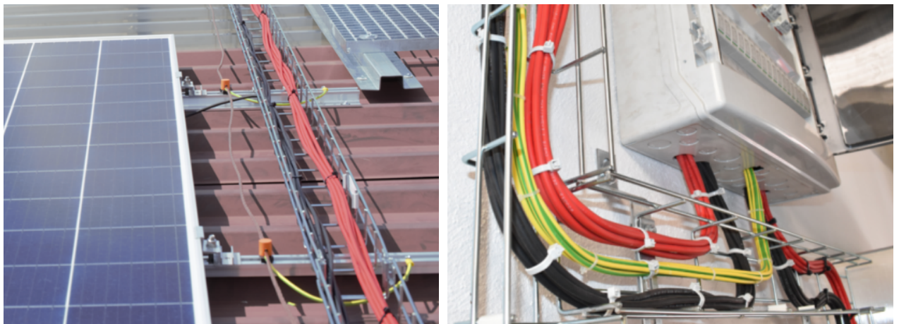
Fig. 27 Detalles de canalizaciones sobre rejilla metálica con bridas para intemperie (negras) e interior (blancas)
