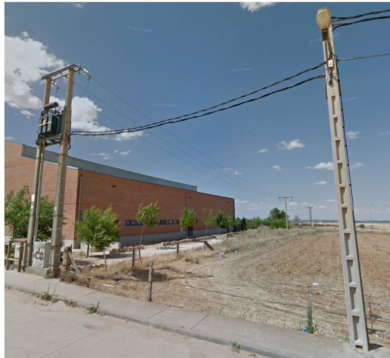
Fig. 7 El nuevo suministro en BT se obtendrá de la 4ª salida que queda libre del armario de protecciones fusibles del centro de transformación que se muestra
