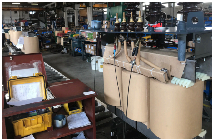
Fig. 74 Parte activa con tapa ya instalada, durante la comprobación de continuidad y del grupo de conexiones. [GED]
