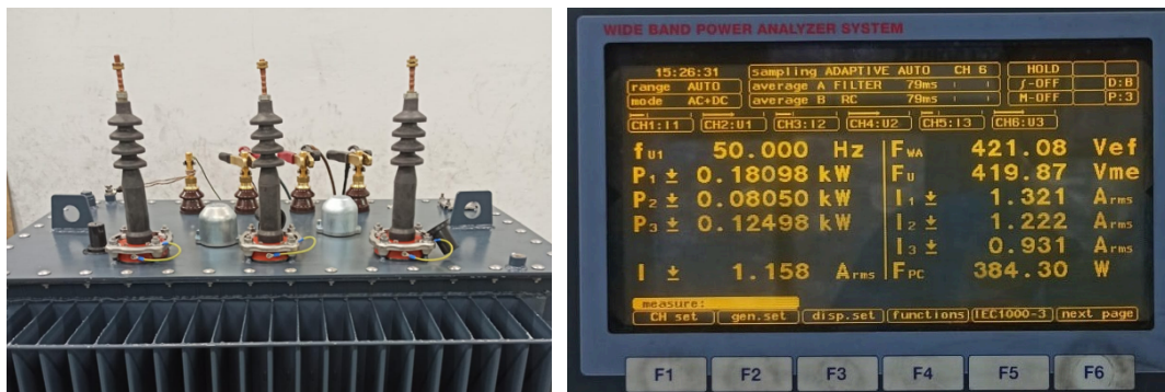
Fig. 102 Transformador 400 kVA durante un ensayo de vacío (hecho por el secundario) y medidas del vatímetro. [GED]
