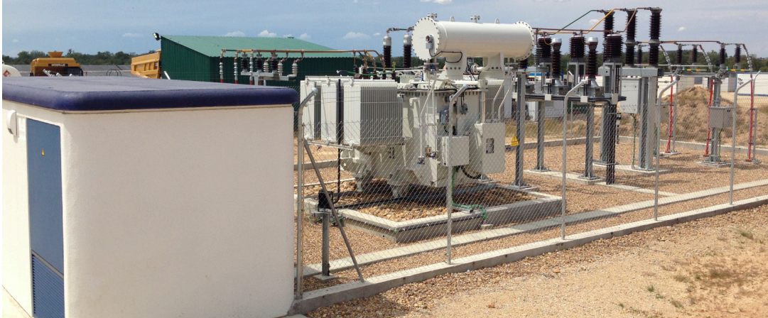
Fig. 90 Pequeña subestación eléctrica en una mina al aire libre. El armario grande del transformador controla localmente el cambiador de tomas en carga.
