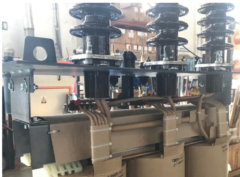
Fig. 87 El cilindro negro central es el conmutador del cambiador de tomas. [GED]
